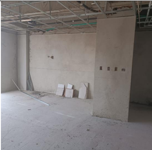
PISO 17: ESTRUCTURA DE CIELO RASO. DESCOLGADAS ELECTRICAS
