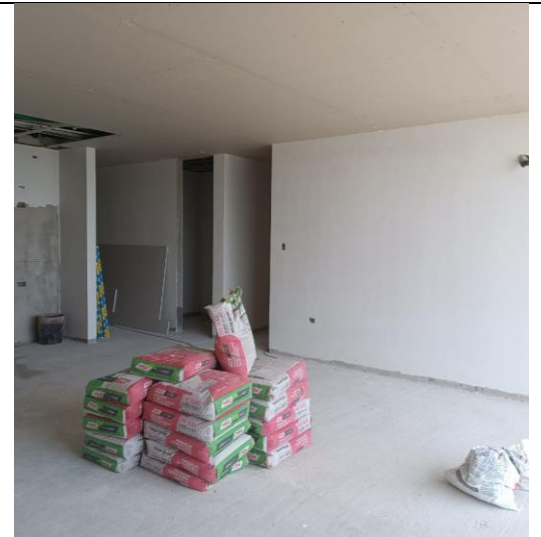
PISO 17: LAMINADO DE CIELO Y SUBIDA DE MATERIAL PARA INSTALACION DE ENCHAPES
