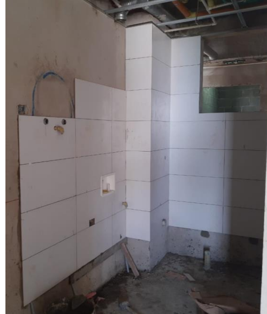
PISO 16: INSTALACION DE ENCHAPES EN MUROS EN BAÑOS Y ZONA DE LABORES
